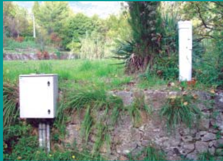
Pluviomètre de Ribes
