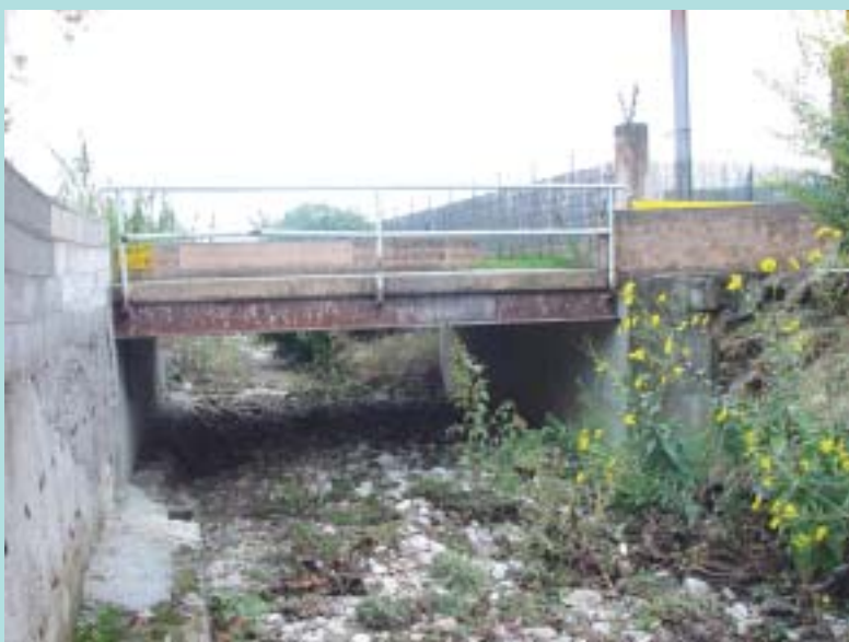
Pont faisant obstacle à l'écoulement du Grand Vallon en crue - Route de la Paoute Grasse ©SISA 2006
